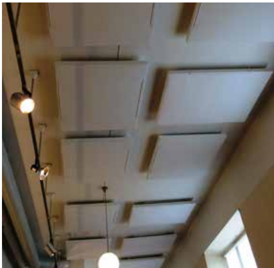
I de långa korridorerna på Gällivare museum har man förbättrat ljudmiljön genom att sätta upp akustikplattor i taket. Foto: Maria Johansson
